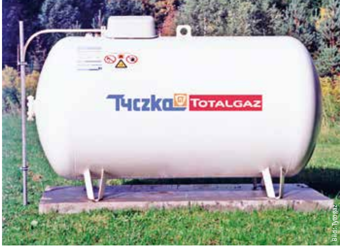
Für die Errichtung von Flüssigastanks gibt es nur noch in Nordrhein-Westfalen eine die Größe betreffende Ausnahme.
