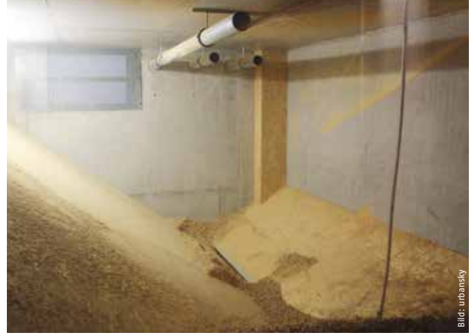
Für Pelletlager mit mehr als 6,5 t gelten gesonderte Anforderungen an den Brandschutz.
