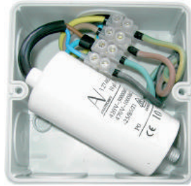
Bild 7: Verteilerdose mit angeklebtem Kondensator
